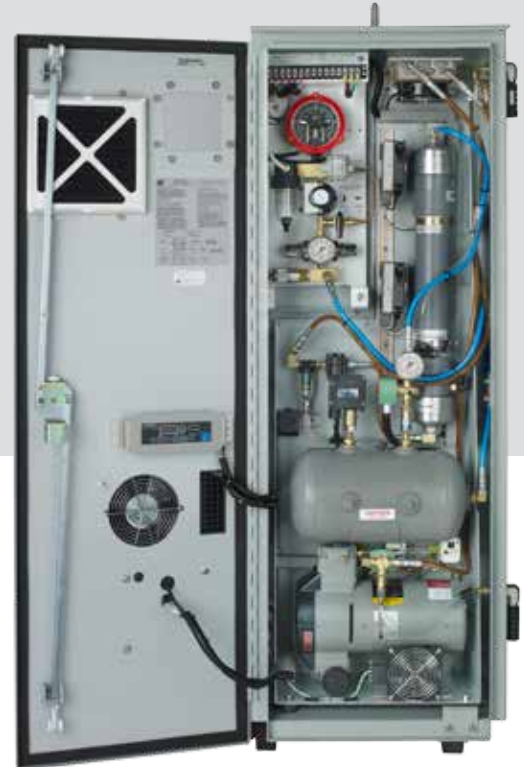
Vista Interior del Sistema de Generación de Nitrógeno de 2nda Generación de Waukesha®.
